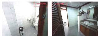
สภาพภายในอาคารชั้นล่าง - ห้องน้ำ (ต่อเติม)
